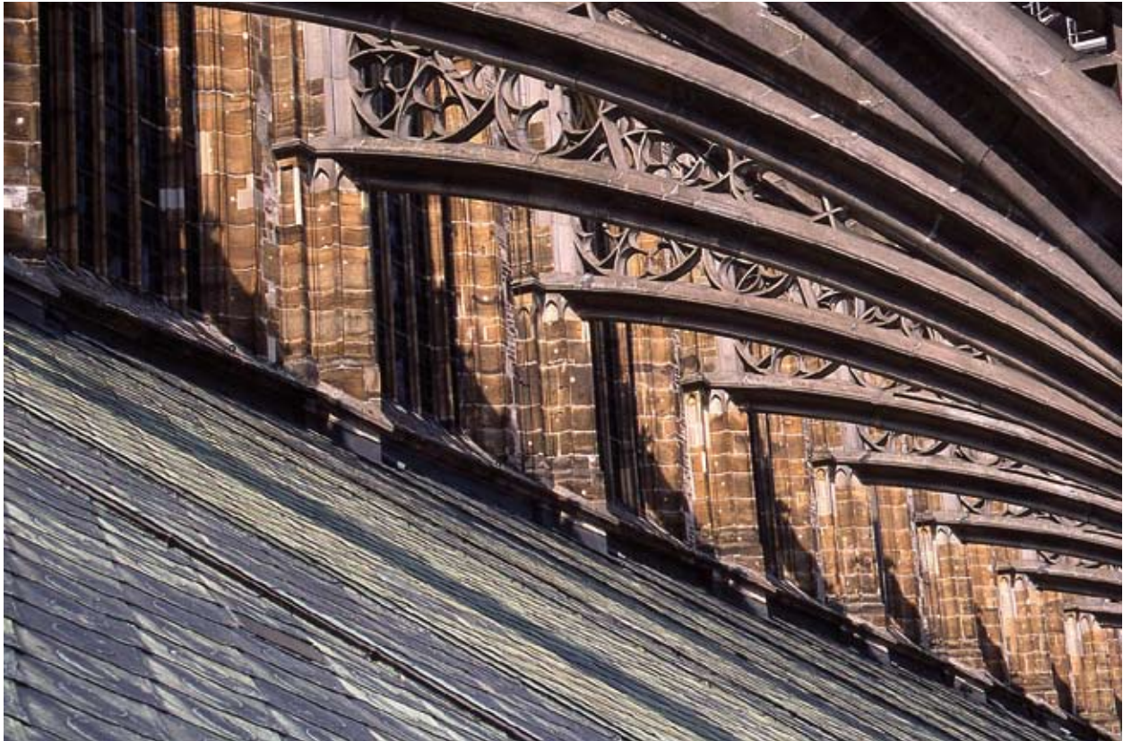
Abb. 65 Am Ulmer Münster wurde der Donzdorfer Sandstein in großem Umfang verbaut. Für die erforderlichen Restaurierungsmaßnahmen müssen nun die alten Steinbrüche wieder aufgesucht und erweitert werden.
