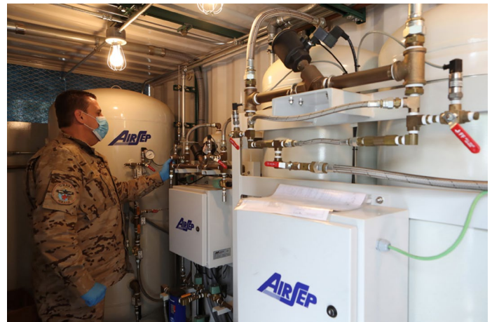
Imagen 4. Contenedor generador de oxígeno. Fotografía de los autores.
