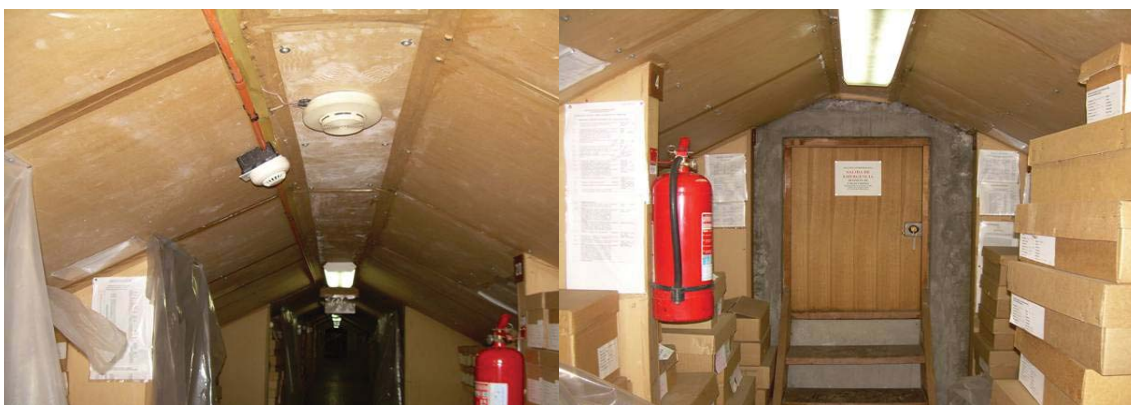
FIGURA 1. Sistemas de sensores de humo y extintores
