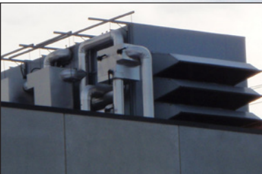
grand système de climatisation de toiture
