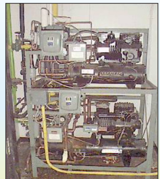
compresseur d'un réfrigérateur-chambre
