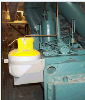
pièce d'équipement conçue pour la récupération des rejets des purges
