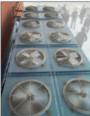
compresseurs d'unité de refroidissement de toiture
