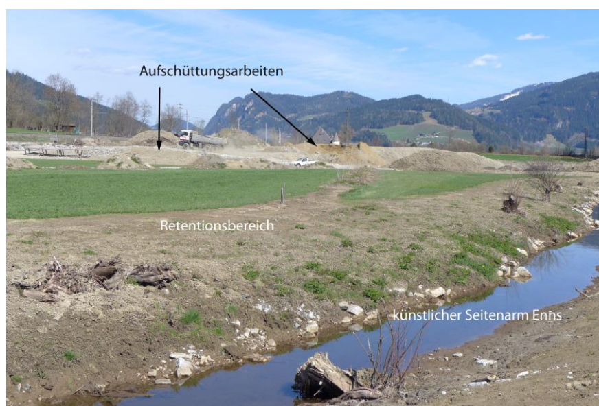
Abb. 31: Bauliche Maßnahmen der Retentionsfläche nahe des Siedlungsbereiches. Im Hintergrund werden Aufschüttungsarbeiten getätigt (Quelle: Eigene Aufnahme).
