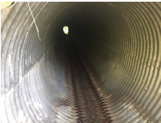
Wellstahldurchlass DN1250 in Richtung Autobahn
