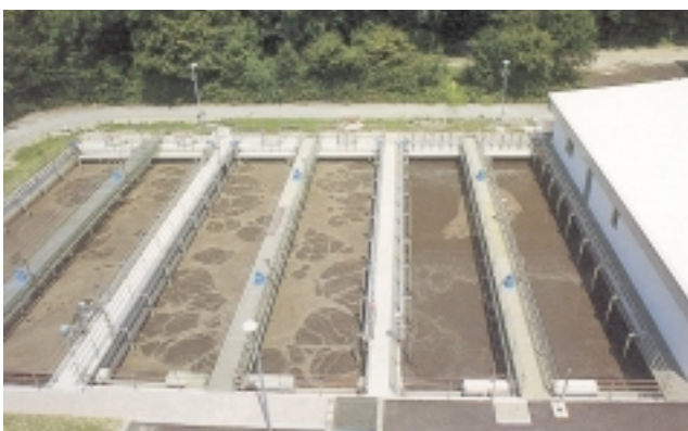
Abb. 3: Belebungsbecken der Kläranlage Kressbronn-Langenargen. Im ersten, unbelüfteten Teil (links) erfolgt die Stickstoffelimination. Im nachfolgenden belüfteten Teil werden die organischen Bestandteile des Abwassers von Bakterien „aufgefressen“ [Quelle: Zweckverband].
