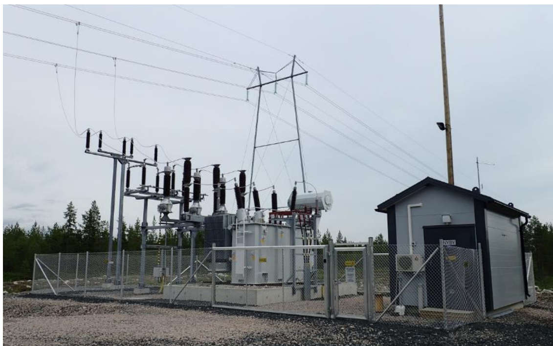
Kuva 72. Esimerkki tuulivoimapuiston sähköasemasta 110 kV (kuva Minna Takalo/FCG).
