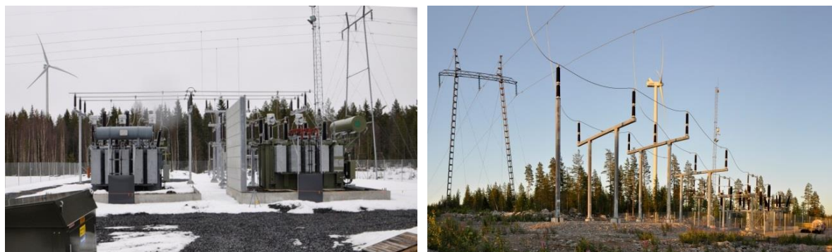
Kuva 78. Esimerkkikuvia tuulivoimapuiston 110/20 kV sähköasemasta. (Kuva: Leila Väyrynen/FCG).
