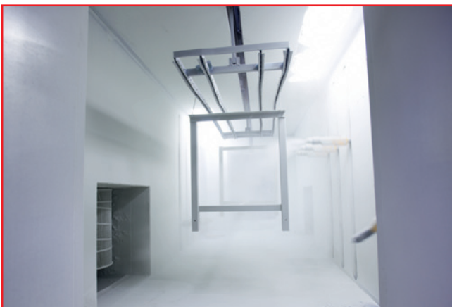
Automatische Pulverbeschichtungsanlage mit insgesamt 4 Beschichtungskabinen.
