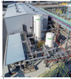
Impianto SMART TB-LNG per la re-liquefazione del BOG. Per gentile concessione di DIG - Depositi Italiani GNL, Ravenna
