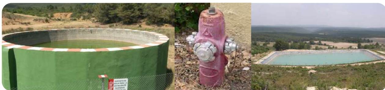
Imatge 82. - Depòsit i hidrant contra incendis, punts d'aigua d'ús específic. Bassa agrícola, ús múltiple. Font: GVA.
