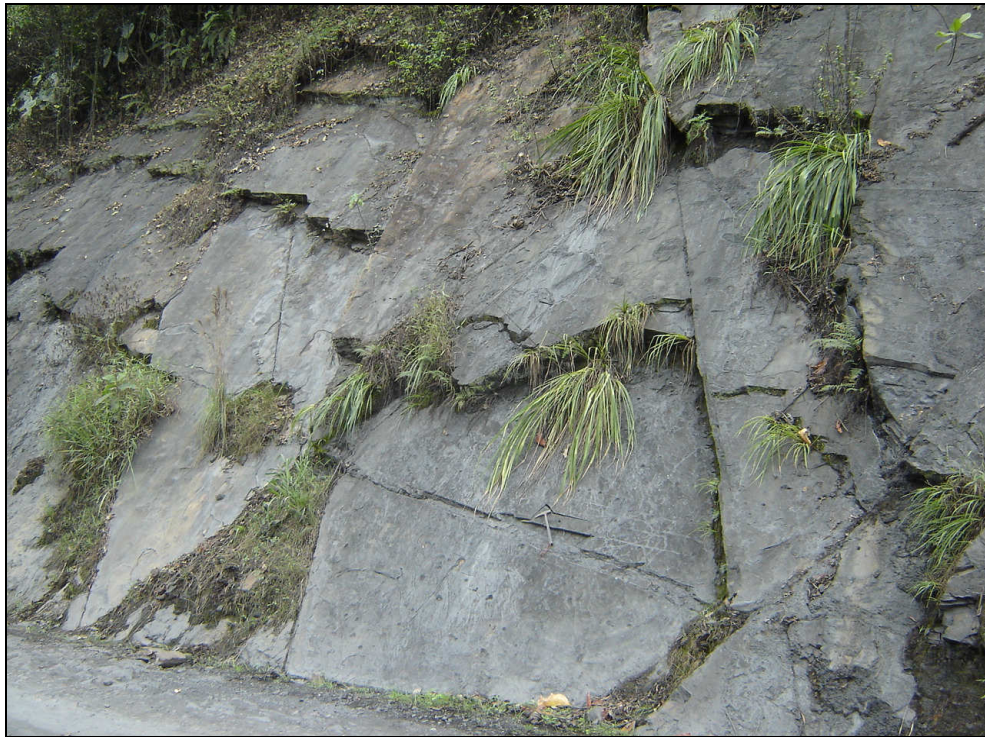
Figura 90. Fracturas subparalelas al nivel de la carretera.
