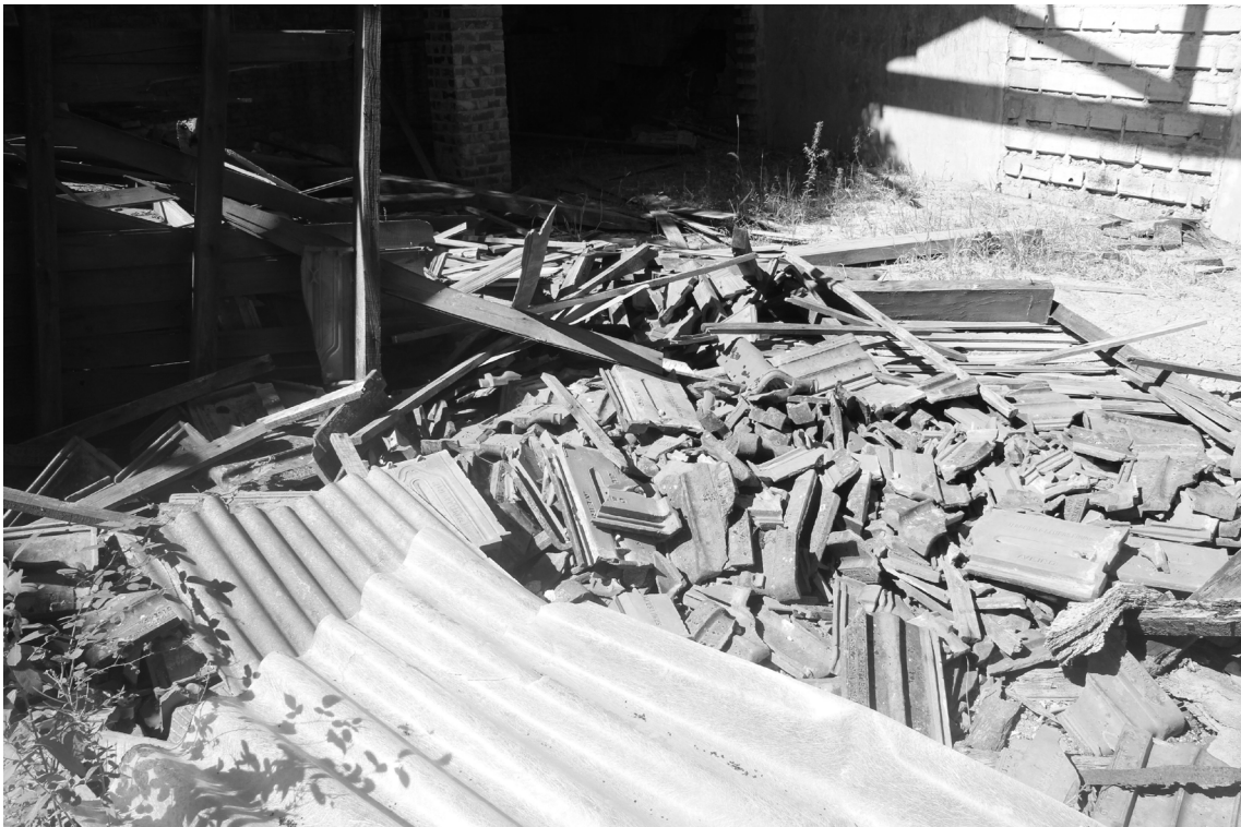
Fig. 2 | Estado de degradação de uma fração da Fábrica Jerónimo Pereira Campos, Alvarães - Viana do Castelo
