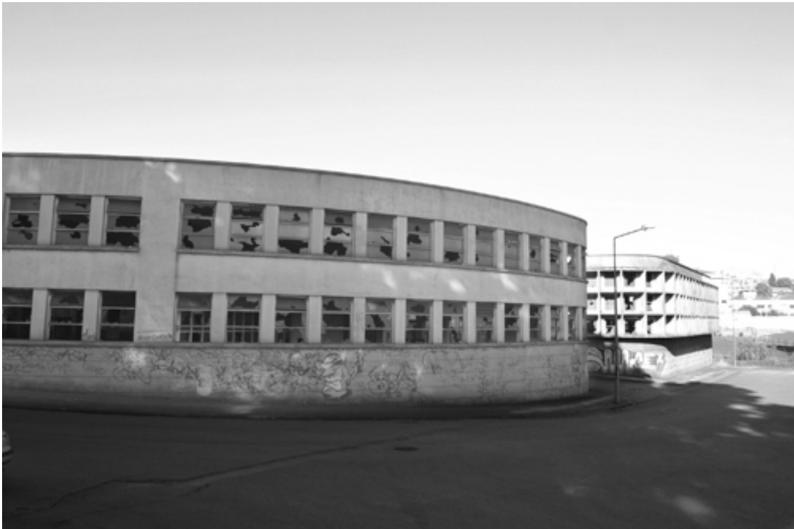
Fig. 18 | Fachadas da Oliva antes da intervenção
