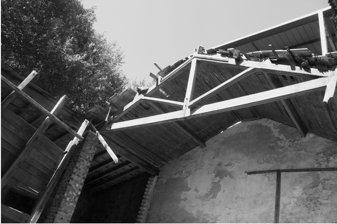
Fig.1 | Estado de degradação de uma fração da Fábrica Jerónimo Pereira Campos, Alvarães - Viana do Castelo
