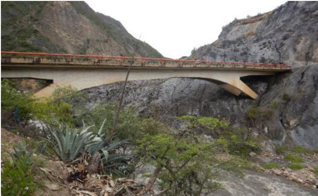
Fotografía 2: Muestra los estribos de la margen izquierda del puente de acceso a Socosbamba y Piscobamba, que pueden verse afectados por fuerzas de empuje y presión de la masa deslizante.
