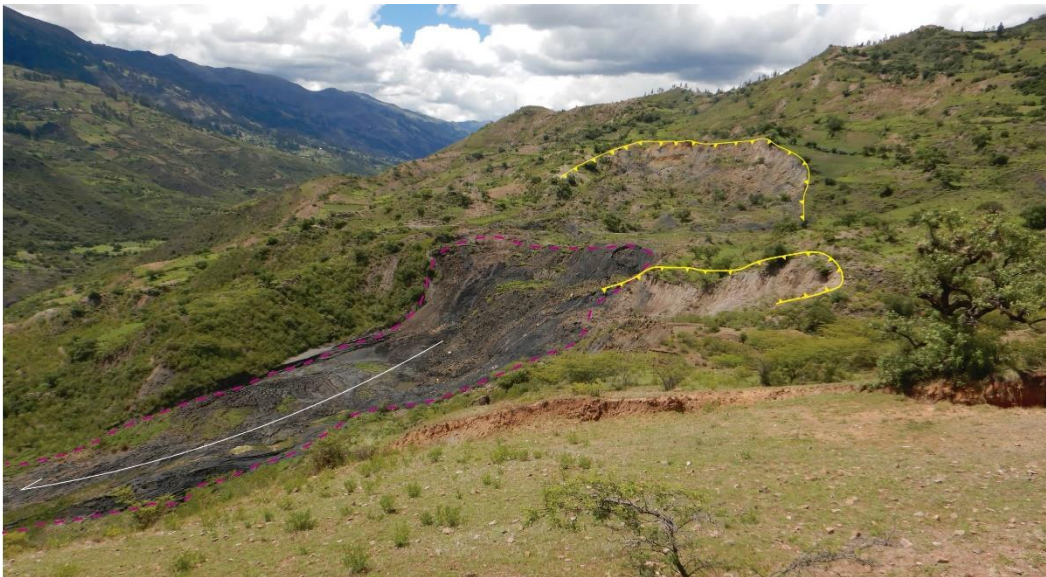
Figura 23: Muestra escarpes principales de 10m de altura del deslizamiento activo, y la zona de flujo de detritos que llega hasta el río Pomabamba.
