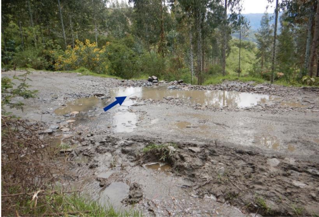
Figura 14: Muestra escorrentía superficial de aguas, que saturan los suelos favoreciendo su movimiento pendiente abajo.
