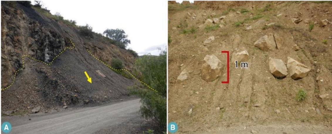
Figura 20: A: Derrumbes por corte de talud. B: Se aprecian bloques con diámetros hasta de 1 m, son de formas angulosas, pueden ceder.
