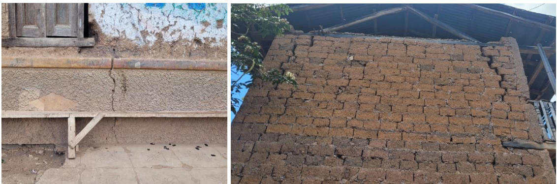
Fotografía 5. Afectaciones en viviendas del caserío Musungate. Ubicación: E: 763084; N: 9316515; Z: 1631.
