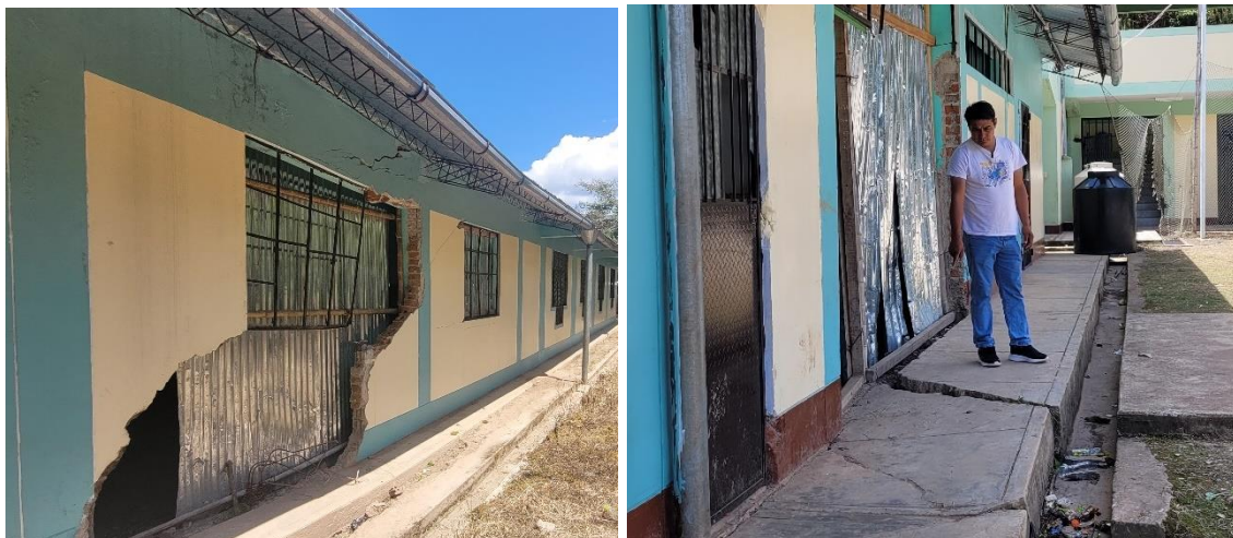
Fotografía 3. Agrietamiento y colapso de muros en la I. E. 16433. Ubicación: E: 763098; N: 9316653; Z: 1621.
