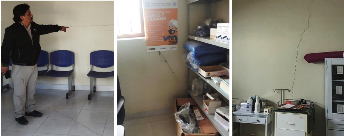
Fotografía 4. Afectaciones en el puesto de salud Musungate. Ubicación: E: 763134; N: 9316524; Z: 1633
