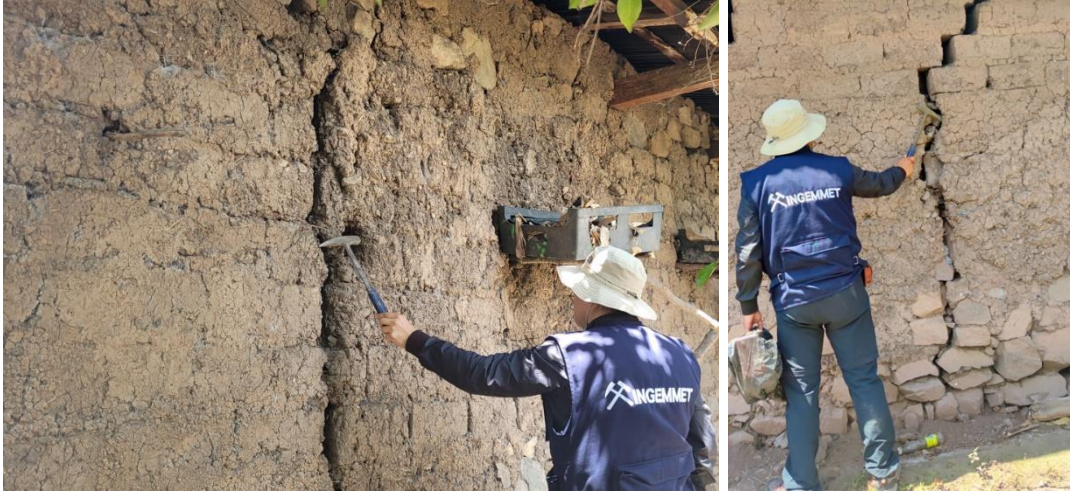
Fotografía 6. Agrietamientos en una vivienda de la parte baja del caserío Musungate. Ubicación: E: 762405; N: 9316706; Z: 1375.
