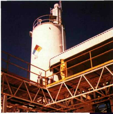
Planta de Neutralización, Mina, N.L.
