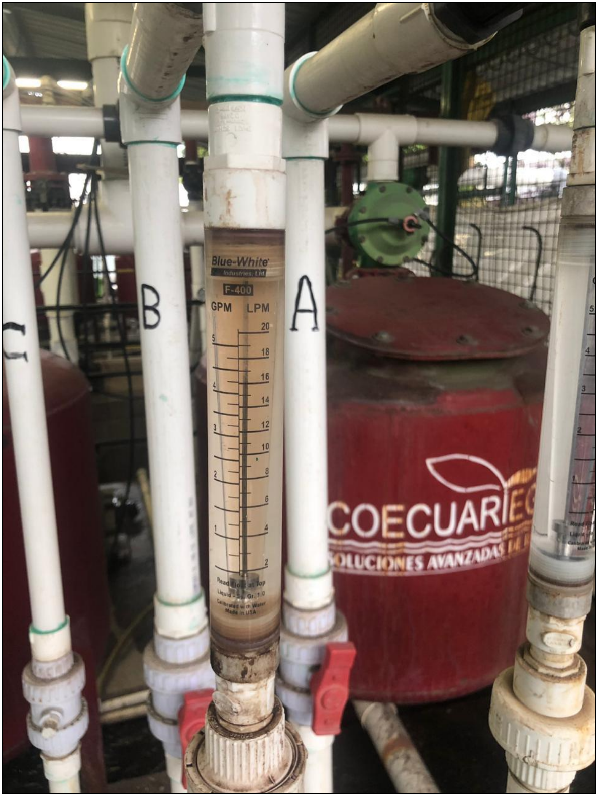
Fotografía 7. Inyectores del cuarto de bombas. Fuente: David Sguerra.
