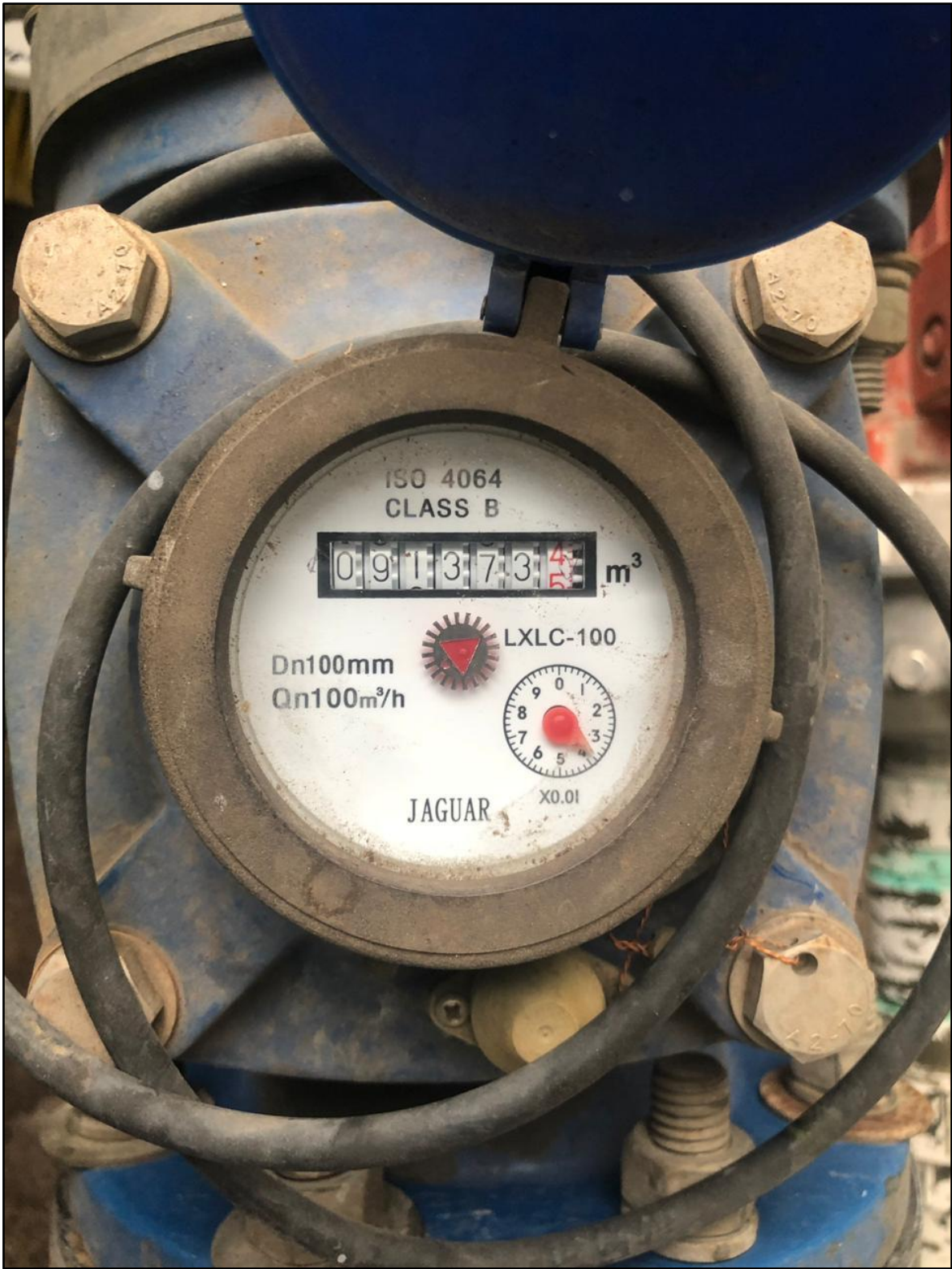
Fotografía 8. Válvula volumétrica. Fuente: David Sguerra.
