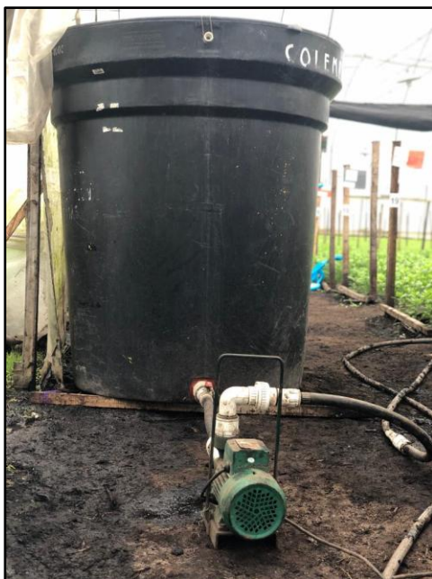
Fotografía 8. Materiales de riego. Fuente: David Sguerra.
