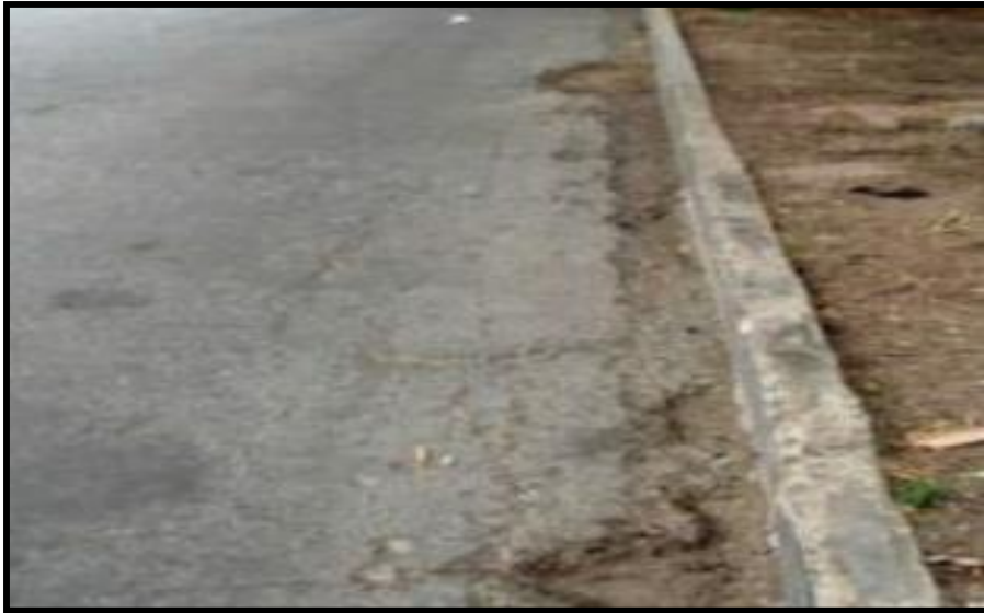
Figura 12. Grietas de borde en la Av. Metropolitana.
