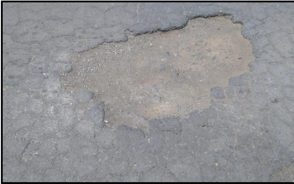
Figura 8. Baches de un pavimento flexible.
