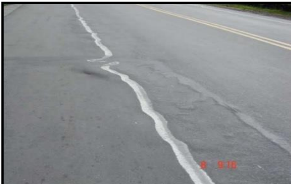
Figura 10. Deformación transversal de un pavimento flexible.
