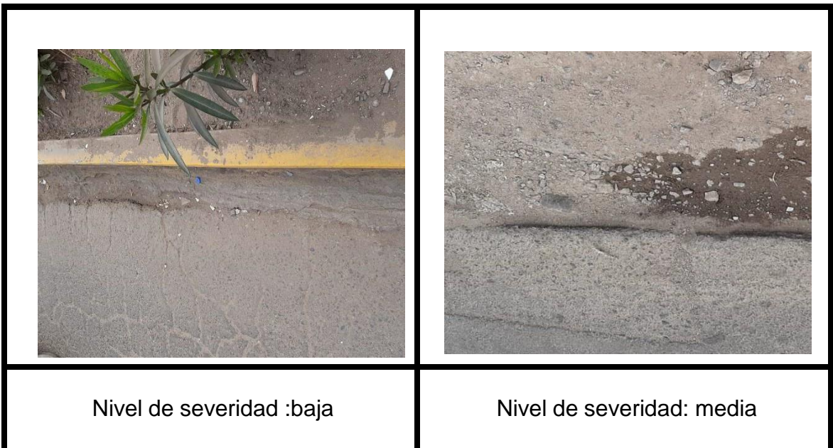
Figura 30: Falla grieta de borde en el pavimento flexible de la avenida Metropolitana
