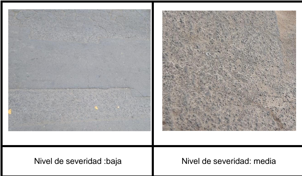
Figura 29: Falla de desprendimiento en el pavimento flexible de la avenida Metropolitana
