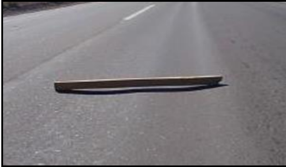
Figura 9. Ahuellamiento en pavimento flexible.
