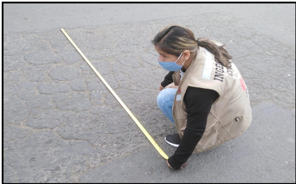
Figura 7. Deterioro en parches de un pavimento flexible.
