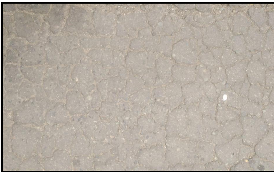
Figura 6. Fallas tipo Piel de cocodrilo en la Av. Metropolitana.
