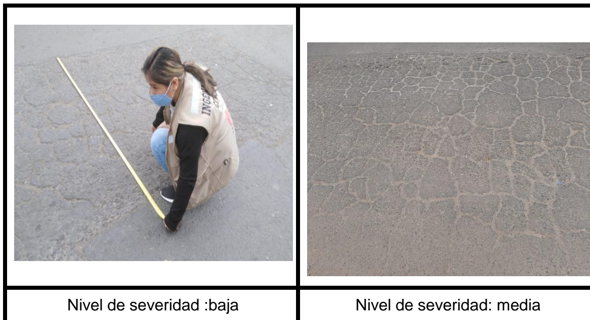
Figura 28: Falla piel de cocodrilo en el pavimento flexible de la avenida Metropolitana
