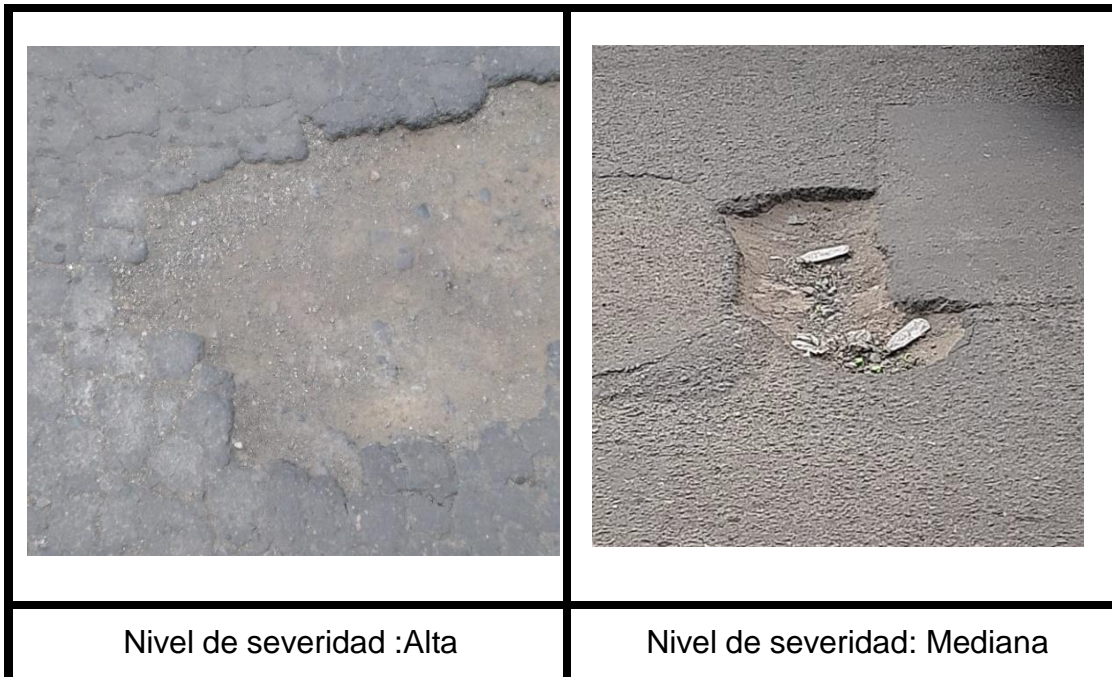
Figura 27: Falla bache en el pavimento flexible de la avenida Metropolitana
