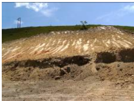
Figura 92 - Retirada da camada fértil de solo em relevo íngreme, por motivos não determinados.
