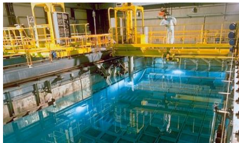
Figura 2. Piscina de almacenamiento inicial de combustible quemado, [6].
