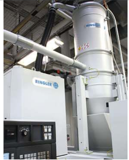
5 Einschalten und läuft: Die hochwertige Späneabsaugung von Ringler ist in eineinhalb Jahren noch keine Minute ausgefallen
