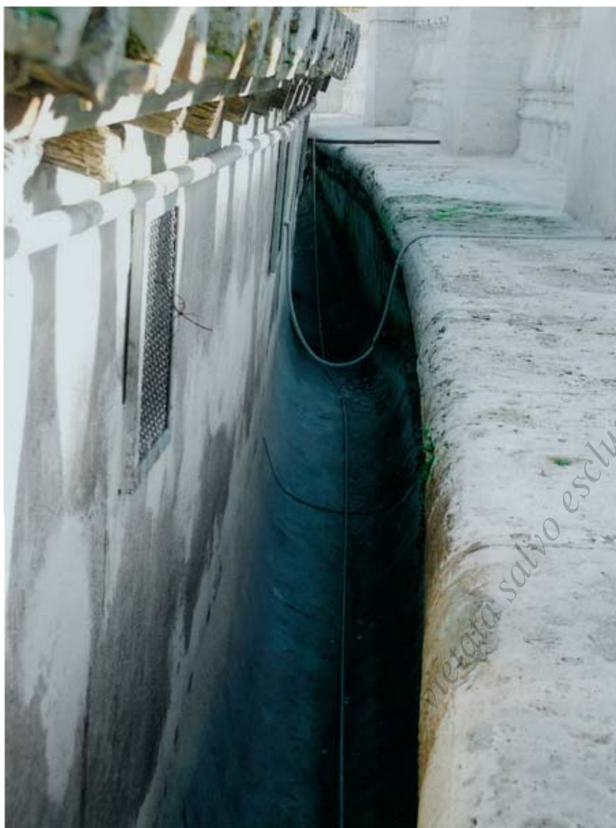
Fig. 103 - Colonnato di S. Pietro. Portico settentrionale. Conversa, particolare. Rispetto al Portico settentrionale, è visibile la quota maggiore della copertura (a sinistra), dovuta all'intervento settecentesco di rifacimento ed innalzamento. Conseguenza è l'affossamento della conversa stessa (foto dell'A.)
