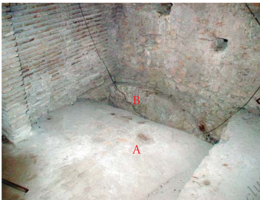
Fig. 71 - Colonnato di S. Pietro. Portico meridionale. Volta a schifo della corsia laterale, estradosso (A). Si noti l'arco di scarico in laterizio (B) (foto dell'A.)
