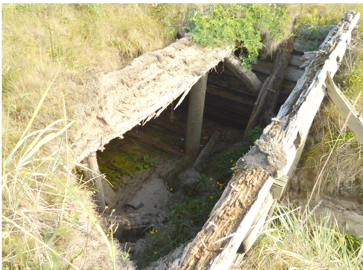
Рис. 9. Сломанная крыша ледника на тоне Турилова (вид на ледник сверху)
