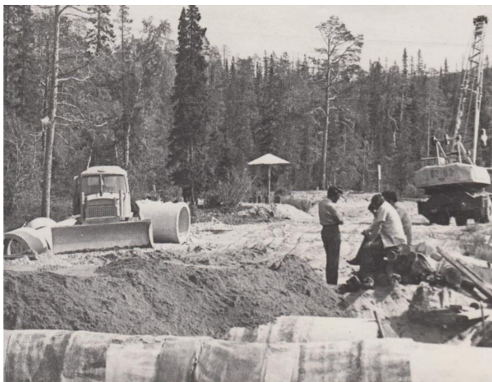
Рис. 11. Строительство дороги от кордона «Н. Чуна» до Чунозерской усадьбы (1978 г.). Фото Е. Н. Панкратова
