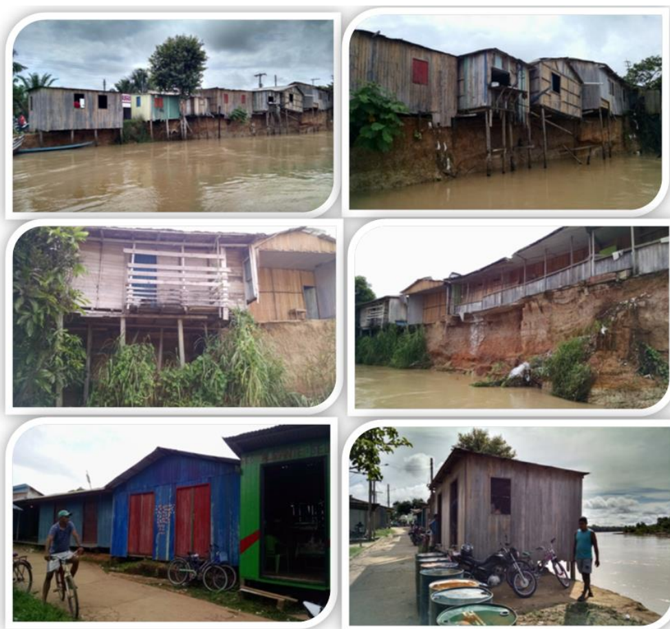
Figura 07 – Locais da orla da cidade onde a pressão da convexidade do meandro provoca erosão fluvial
