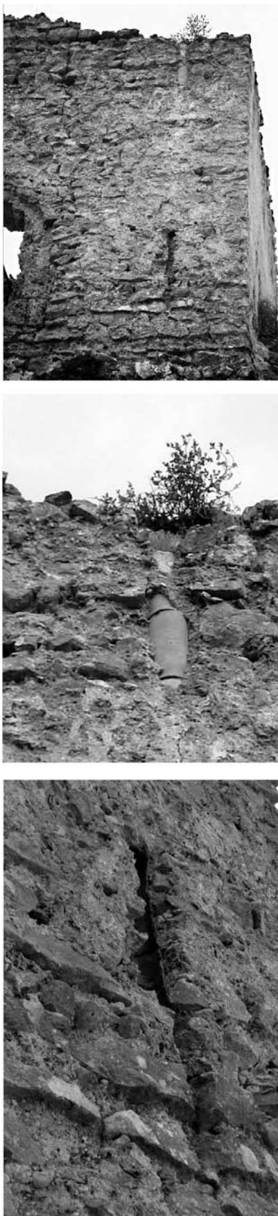
Figura 12: Desagüe embutido en el muro noroeste de la torre. Foto superior: sector de la fachada noroeste donde se distingue el desagüe, en el centro y abajo: imágenes de detalle.
