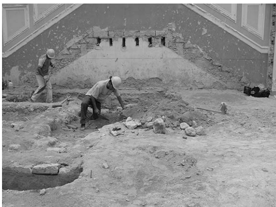
Figura 3 – Lado Oeste do edifício, quadrículas A, B e G, vista inicial da intervenção.
