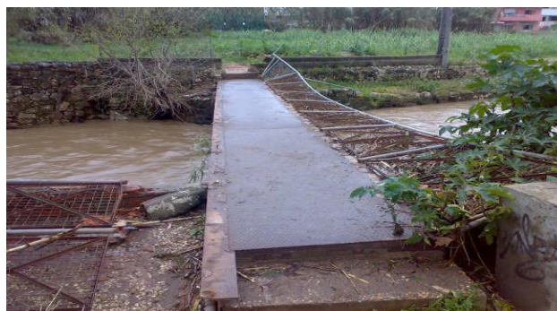
Fig. 25 - Consequências de fortes chuvadas de 2008 junto à urbanização Pedreira Italiana
