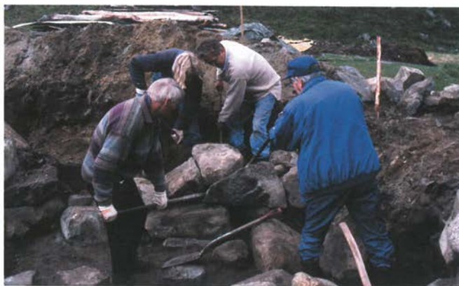
Rørslemønster i byggegrunnen til lóa på Sandsa. Unge og gamle arbeider i lag og lærer ved å ta etter kvarandre. Dei som er med: Ingvar Omdal, Espen Martinsen, Per Surnevik og Albert Moe
