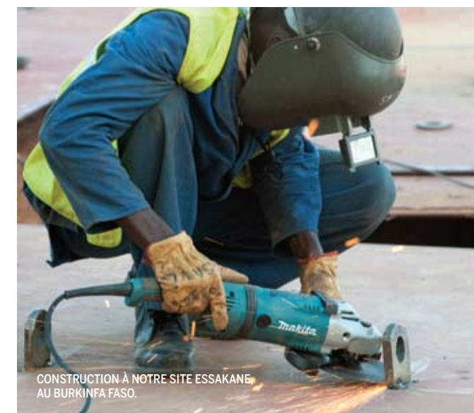
ESSAKANE A RÉALISÉ PLUS DE TROIS MILLIONS D'HEURES TRAVAILLÉES SANS INCIDENT ENTRAINANT DES JOURS D'ABSENCE.
