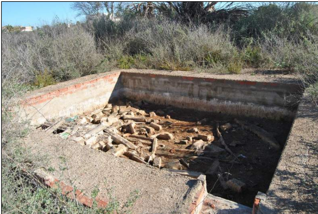
Figura 10. Restos de una balsa en desuso ubicada en la parcela 1.
