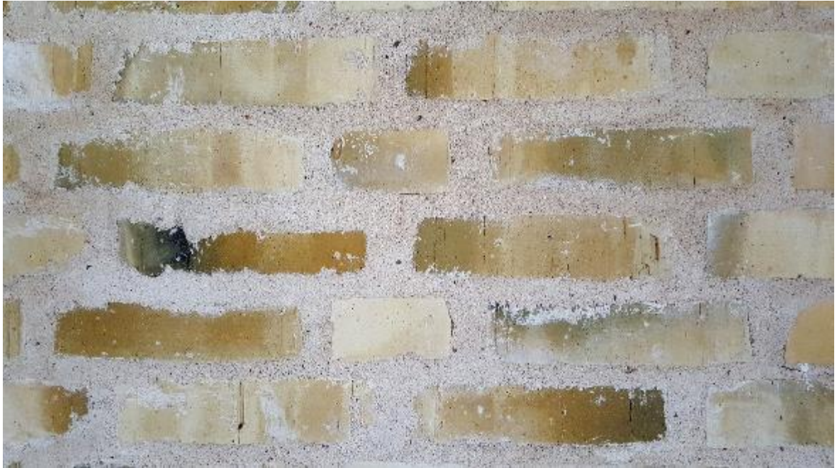
2. 10 Kirkerummets murværk med grov fuge og fingeraftryk
