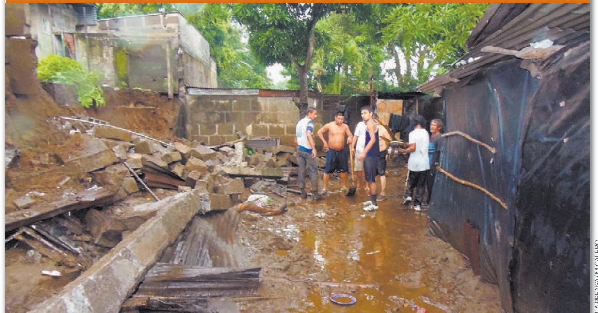
Dos muros perimetrales se derrumbaron producto del fuerte aguacero, matando a tres personas de una misma familia.
