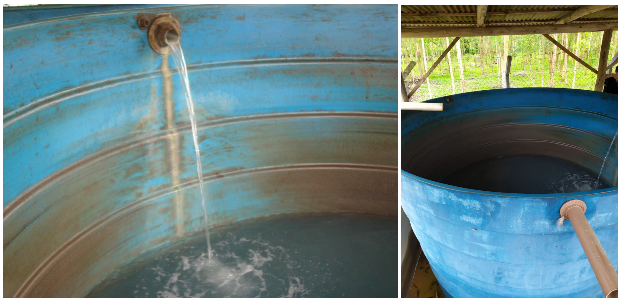
Figura 06 – Efluente no reservatório 02.
