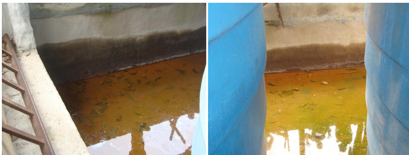
Figura 04 – Bacia de contenção dos reservatórios, com presença de água indicando possibilidade de infiltrações.
