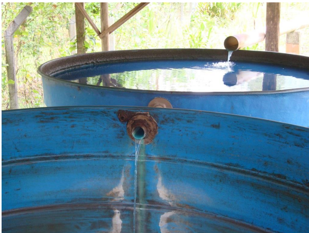
Figura 03 – Reservatórios interligados para armazenamento de efluente industrial.
