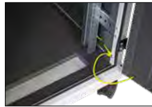
Frischluftezufuhr über Filtergitter im Boden
