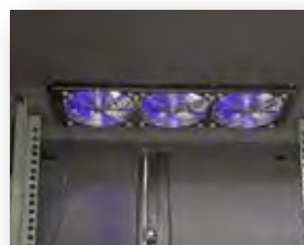
3 x Super-Silent Lüfter im Dachbereich
