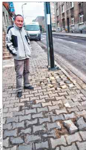
Chodnik po remoncie pozostawia wiele do życzenia, nie mówiąc już o samych przyłączach – mówi Adam Stowski.
