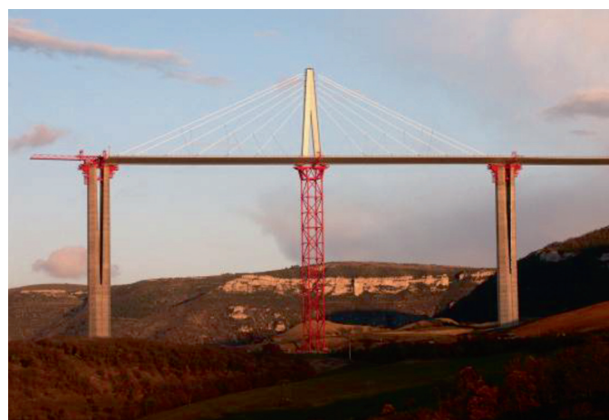
Photo n°8 - Phase où un pylône se trouve sur un appui provisoire. (Photo J.-P. Muzeau)
