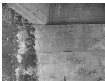
Figura 16 . Grieta horizontal en la mitad de la altura del estribo
