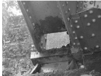
Figura 37. Problemas de corrosión, pérdida de sección de cordón inferior Figure 37. Corrosion problems, loss of section in the lower bead
