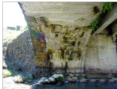
Figura 35. Fisuras y eflorescencias Figure 35. Fissures and efflorescence
