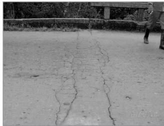
Figura 5. Deterioro de junta cubierta de mezcla asfáltica Figure 5. Damage of joint covered by asphaltic layer
