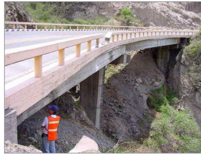
Figura 12. Deslizamiento del talud adyacente del puente que afecta los conos y taludes del puente.
