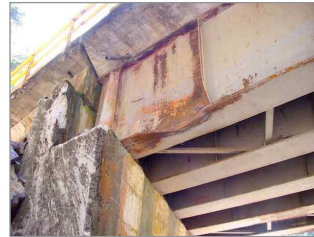
Figura 33. Corrosión e impacto, generó disminución de sección de viga Figure 33. Corrosion and impact provoked a beam section reduction
