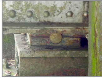
Figura 24. Corrosión y deterioro del apoyo balancín de acero Figure 24. Corrosion and deterioration of steel bearing outrigger
