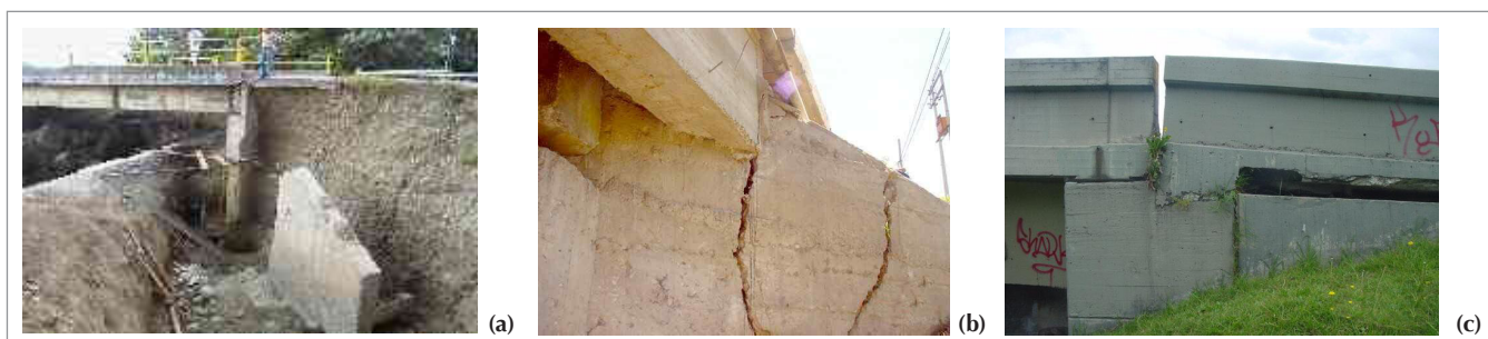
Figura 14. (a) Falla de aleta por socavación. (b). Grietas por falta de capacidad de carga de las aletas, producidas por un probable asentamiento. (c) Asentamiento en terraplén de acceso que afecta la aleta
