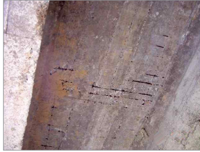
Figura 26. Acero expuesto y recubrimiento insuficiente
