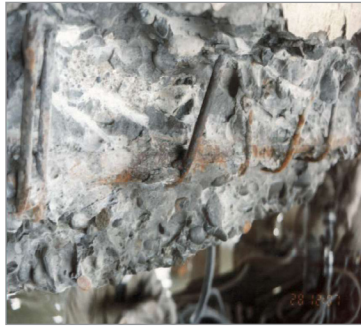
Figura 32. Corrosión por baja de pH y cloruros. Figure 32. Corrosion due to loss of PH and chloride content
