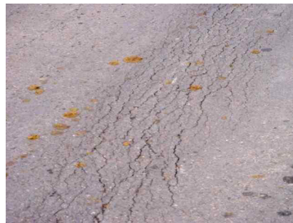
Figura 2. Carpeta descompuesta, grietas de cocodrilo
