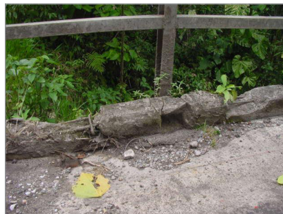
Figura 8. Bordillo descompuesto Figure 8. Damaged curb
