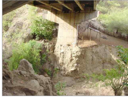
Figura 20. Material de soporte de pila afectado por socavación Figure 20. Bearing pile material affected by undermining
