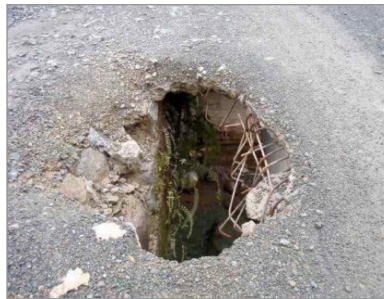
Figura 28. Falta de capacidad de carga de la losa
