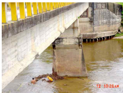
Figura 44. Puente Banadia. Puente que colapso recientemente por socavación Figure 44. Banadia Bridge recently collapsed due to undermining
