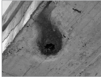
Figura 27. Infiltración de la losa por deficiencias al tener drenes cortos
