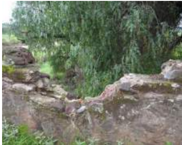
Imagen 15. Daños al puente de la Quemada. Autor: Rigoberto Servín. 2018.
