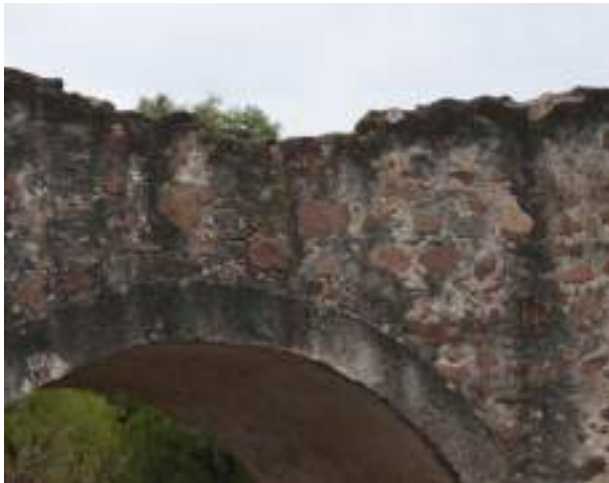
Imagen 14. Daños al puente de la Quemada. Autor: Rigoberto Servín. 2018.
