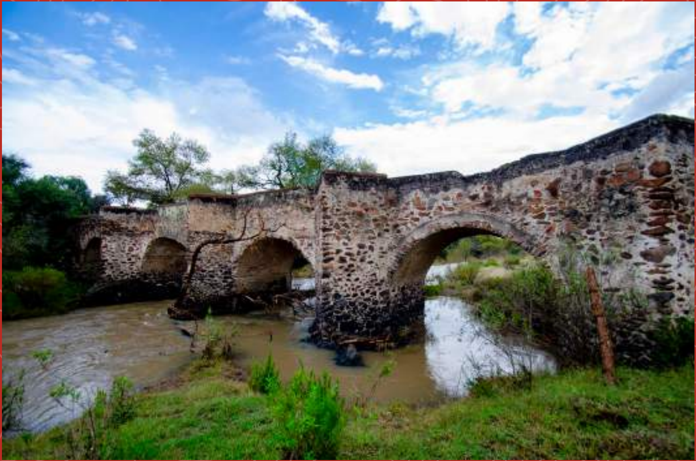
Imagen 18. Panorámica del Puente de la Quemada en el curso del Río Laja.
