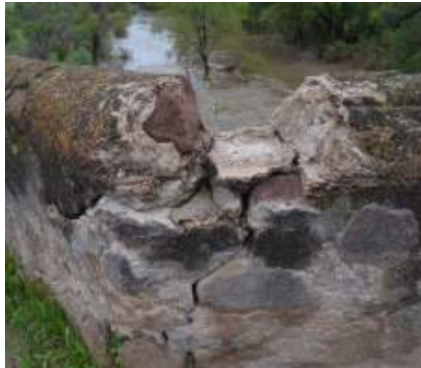
Imagen 17. Otros daños al puente de la Quemada. Autor: Rigoberto Servín. 2018.
