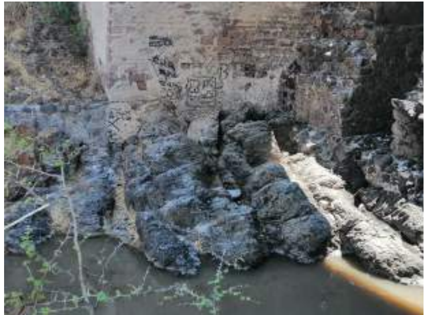
Imagen 4. Lecho basáltico y estructura de presa de gravedad. Autor: Luis Felipe Rodríguez. 2021.
