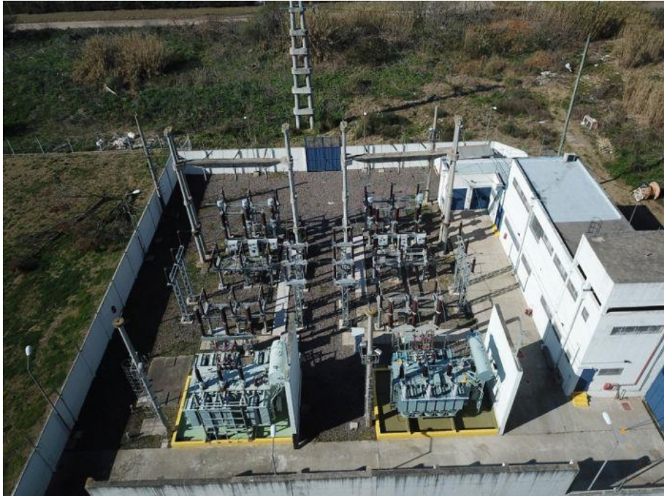
Figura 3.1. Estación Transformadora AT/MT de EDELAP, "Subestación Sur" [2]
