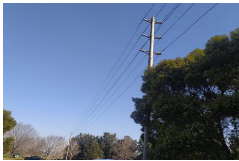
Figura 4.16. Línea aérea de MT tipo Line Post
