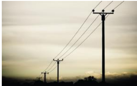
Figura 4.15. Línea aérea de MT tipo coplanar horizontal
