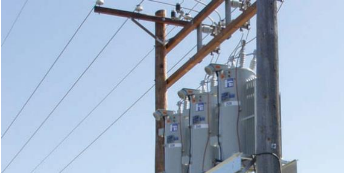
Figura 4.36. Reguladores monofásicos en plataforma aérea de sistema de distribución primaria
