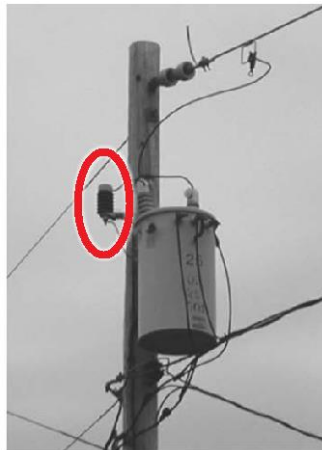
Figura 4.52. Descargador instalado junto a transformador monofásico MT/BT
