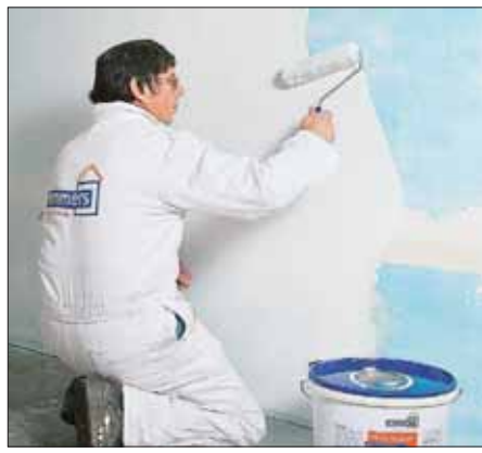
Schimmel im Wohnzimmer sollte unbedingt verbannt werden. Dazu sollte man den Ursachen auf den Grund gehen. swb-Bild: remmers
