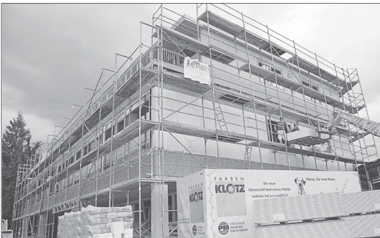
Noch wird an dem Gebäude in der H.-E.-Busse-Straße in Stockach gearbeitet, doch im Juli soll es bezugsfertig sein.
