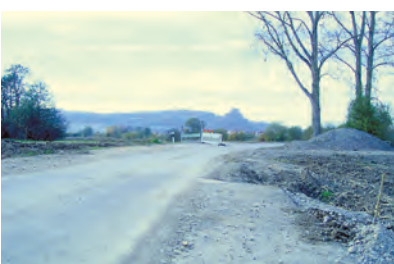
Möglich trotz modernster Messtechnik: Zwei Straßen stoßen mit einem Meter Unterschied aneinander.
