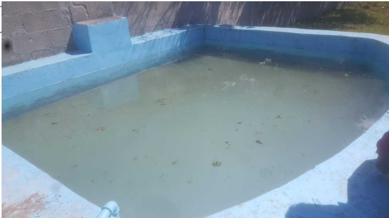
ACUMULACION DE AGUAS SUCIA EN LAS PILETAS PARA ABASTO DE FLOREROS
