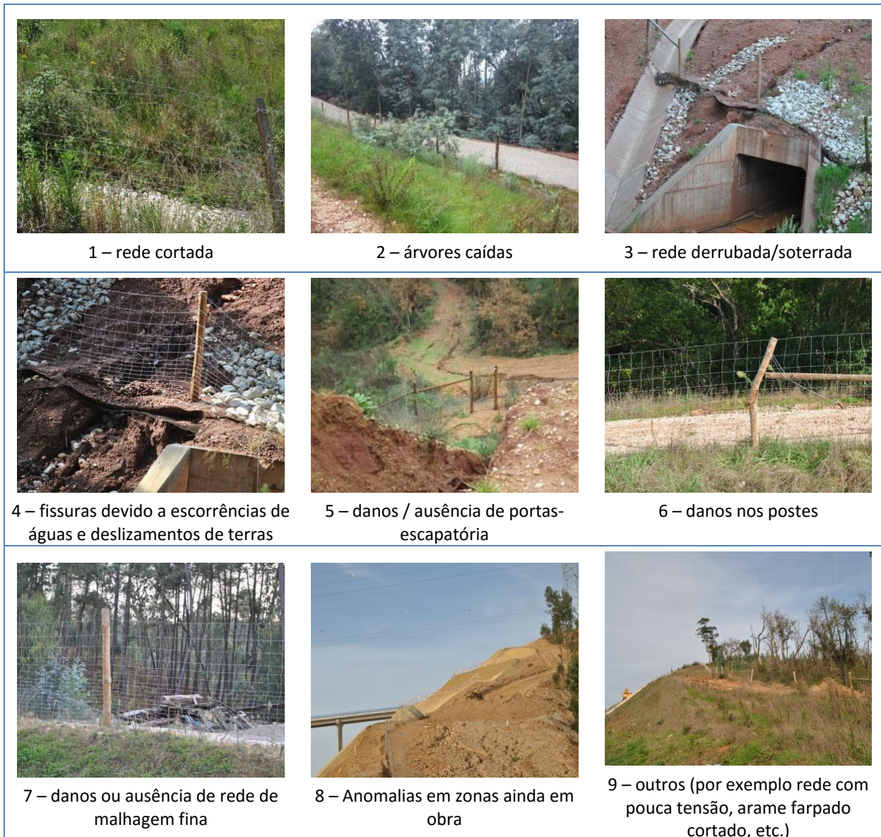
Figura 6 - Exemplos de danos observados na vedação, no decorrer das campanhas de monitorização realizadas no 2º ciclo anual da fase de exploração, nos lotes 1, 2, 3, 4, 6 e 11 da Subconcessão do Pinhal Interior.
