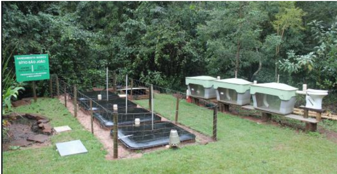
Figura 9: Sistemas Biodigestores construídos no Sítio São João em São Carlos
