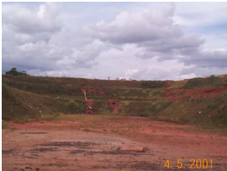
Figura 70 – Recuperação da voçoroca do Jd. Líbano, no município de Franca. Tomador: DAEE
