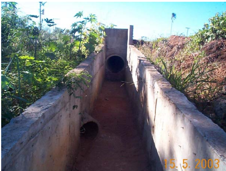
Figura 69 - Galeria de Águas Pluviais da Av. Perimetral, no município de Ribeirão Corrente. Tomador: Prefeitura Municipal de Ribeirão Corrente.
