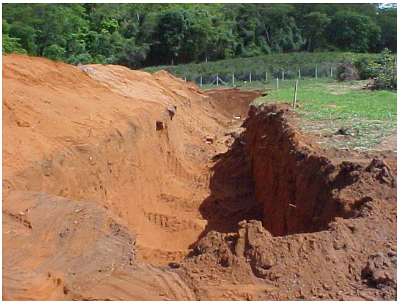
Figura 56 – Implantação do Aterro Sanitário do município de Cristais Paulista Tomador: Prefeitura Municipal de Cristais Paulista.
