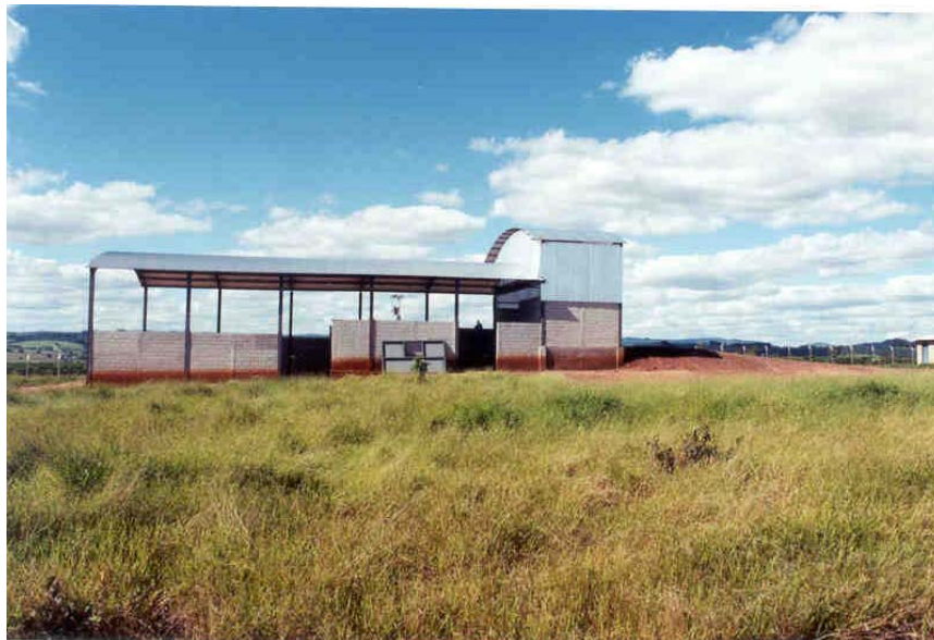
Figura 57 – Implantação de melhorias no Aterro Sanitário do município de Santo Antônio da Alegria Tomador: Prefeitura Santo Antônio da Alegria.
