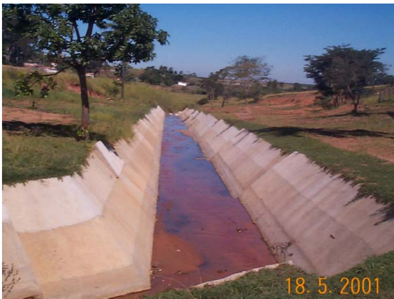
Figura 65 – Canalização do Córrego Cascata, no município de Pedregulho. Tomador: Prefeitura Municipal de Pedregulho
