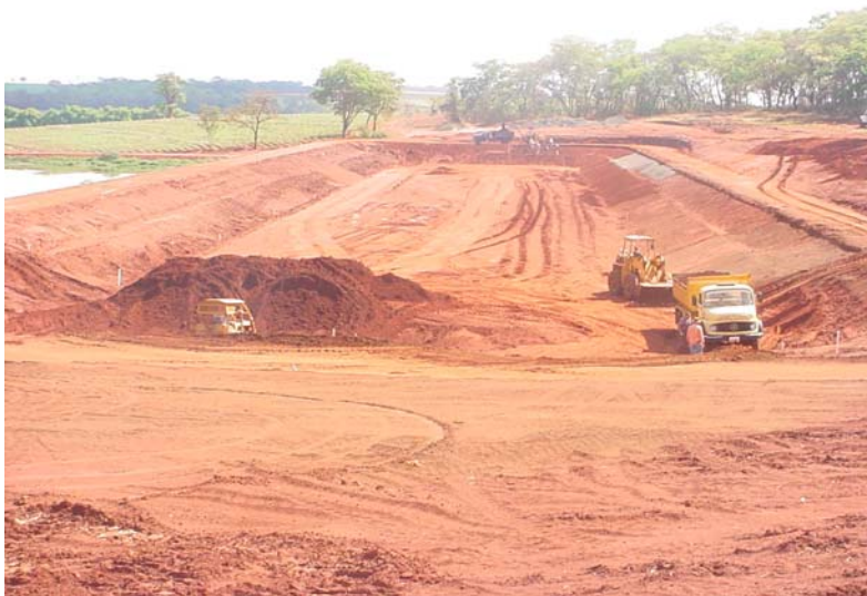
Figura 73 - Estação de Tratamento de Esgotos Tomador: Prefeitura Municipal de Aramina
