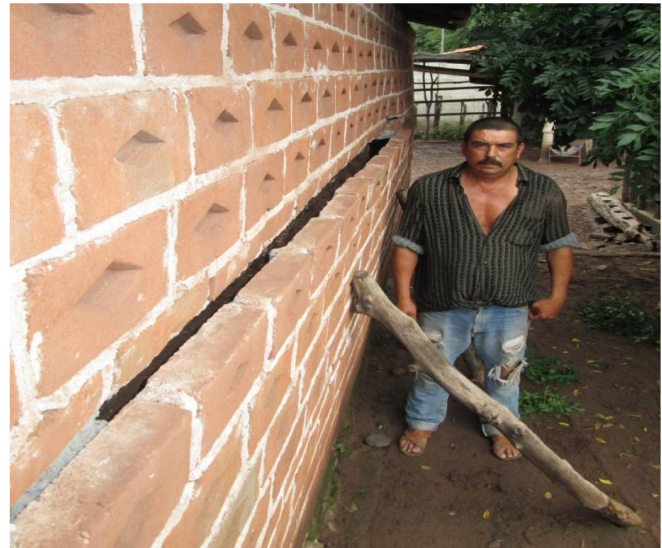
Imagen 101.- Los daños estructuras se dejaron ver el algunas viviendas de la localidad de Acucha de Cajoncitos. Fuente: Joel Avilés Alejandre.
