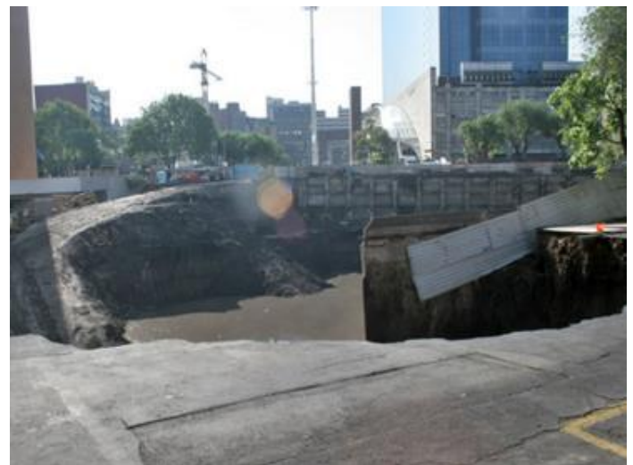
Imagen 62.- En la imagen se puede observar un hundimiento en la Cd. De México en la colonia Nápoles el cual se presenta por la sobreexplotación de los mantos acuíferos, por la extracción excesiva de agua del subsuelo. Fuente: http://www.informador.com.mx/6724/hundimiento-en-la-ciudad-de-mexico
