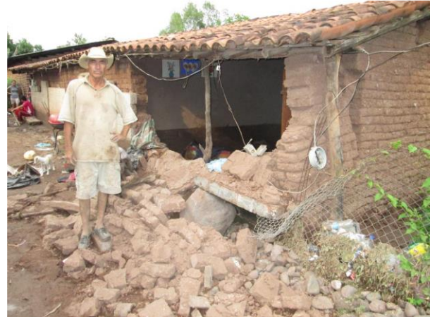
Imagen 99.- Los muros de mampostería de adobe de la localidad de Acucha de Cajoncitos no resistieron el embate de la corriente y terminaron por colapsarse. Foto tomada por Joel Avilés Alejandre.
