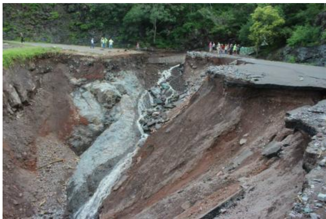
Imagen 12.- Corte total en la Carretera Tuzantla-Tiquicheo a la altura de la cuesta del venado registrada el 23 de Septiembre 2013. Foto tomada por: foto tomada por: Joel Avilés Alejandre.
