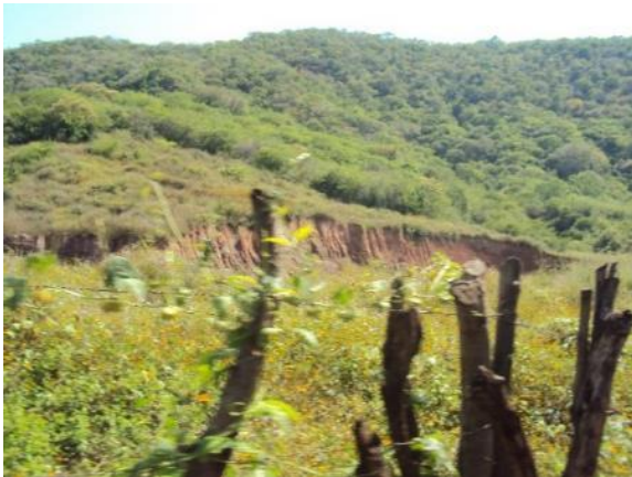
Imagen 60.- La localidad del El Balseadero en donde se encuentra el corte de terreno que han realizado los pobladores a este cerró el cual los coloca vulnerables ante un posible derrumbe. Fuente: Consultoría Leviuqse
