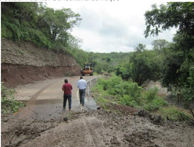
Imagen 59.- Derrumbe en la carretera debido a corte que se hizo para poder construirla, lo que provoca que esta se convierta en un peligro para la circulación de vehículos por los escombros que se pueden desprender. Foto tomada por Joel Avilés Alejandro
