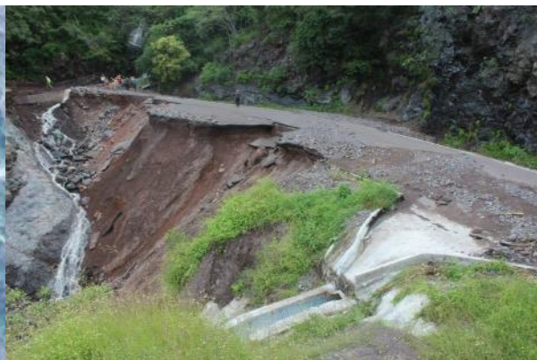
Imagen 48.- Donde se observa el daño causado en la carretera Tuzantla-Tiquicheo y la zona de hundimiento que de dejo severamente dañada la vialidad. Fuente: Presidencia de Tuzantla. Foto tomada por Joel Avilés Alejandre
