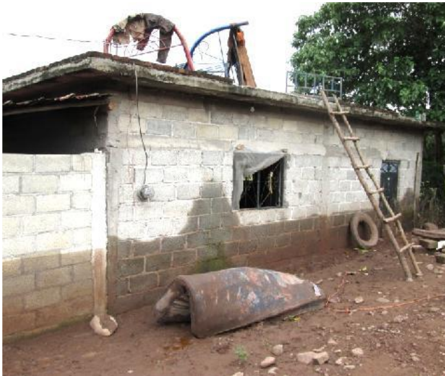
Imagen 100.- El nivel del agua alcanzo casi el metro de altura en la localidad de Acucha de Cajoncitos, en el cual se puede apreciar en la vivienda. Fuente: Joel Avilés Alejandre
