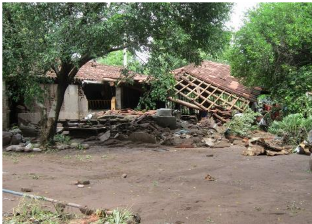
Imagen 9.- La estructura de las viviendas se vio endeble ante la creciente del arroyo y terminaron por colapsarse en la localidad de Paso de Tierra Caliente. Foto tomada por foto tomada por: Joel Avilés Alejandro.
