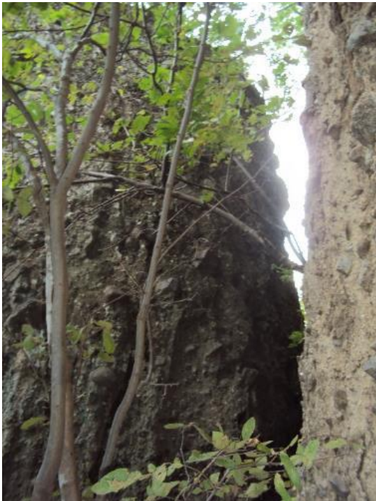
Imagen 20.- La fractura que se registró en la zona rocosa de Tuzantla, ocasionó que se desprendiera un fragmento de roca, y que esto ponga en riesgo a la Cabecera Municipal ante un posible de derrumbé. Fuente: Consultoría Leviuqse.
