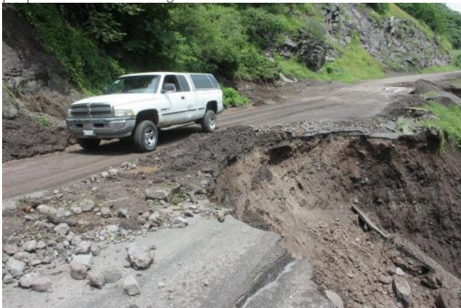
Imagen 50.- En la imagen se aprecia las afectaciones en la carretera a la Quiringuca debido a que los flujos en esa zona afectan los materiales con las que esta construidas. Fuente: Foto tomada por Joel Avilez Alejandre
