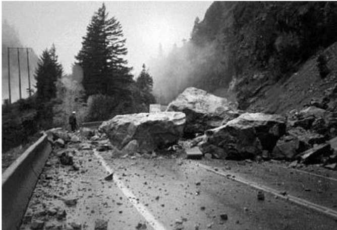
Imagen 53.- Los caídos o derrumbes en el país se presentan principalmente en las carreteras por los cortes que estas realizan a la topografía del lugar. Fuente: Fascículo de inestabilidad de laderas 2001
