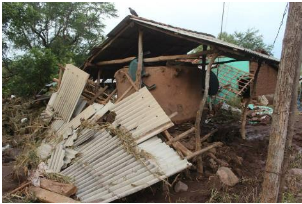
Imagen 10.- En la fotografía se muestra las afectaciones en una vivienda en la comunidad de la Quiringuca, localidad severamente golpeada por las lluvias atípicas que provocaron la creciente del arroyo el Plátano que se localiza a las orillas de la población. 23 de Septiembre 2013. Foto tomada por: foto tomada por: Joel Avilés Alejandre.
