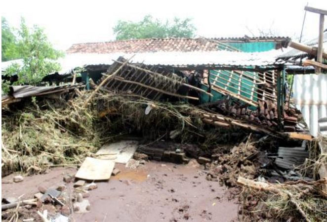
Imagen 96.- La corriente del Arroyo el Plátano arrastró todo a su paso, llevándose parte de una construcción a base de Madera y lamina la cual presentó pérdida total en la Quiringuca. Foto tomada por Joel Avilés Alejandre
