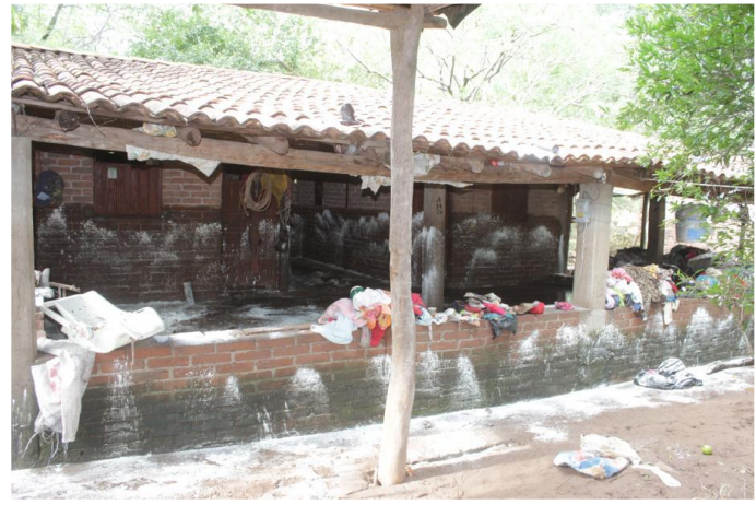
Imagen 106.- En la localidad La Colonia el agua penetro las viviendas sin causar grandes daños en las construcciones solo perdida de enceres. Foto tomada por Joel Avilés Alejandre
