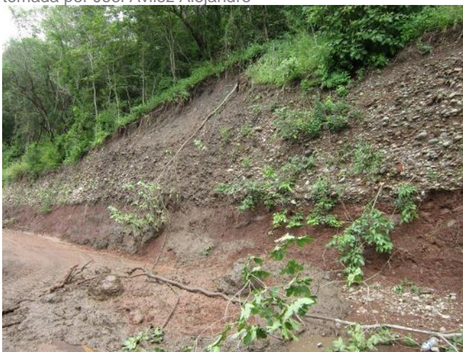
Imagen 51.- Se registraron pequeñas afectaciones en la carretera que comunica a la localidad de La Quiringuca. Foto tomada por Joel Avilés Alejandre
