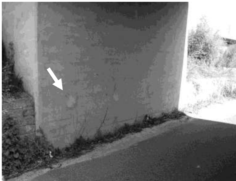
De nu afdækkede huller i landfæstet på broen på Kroghsvej sommeren 2003. Foto: DM
