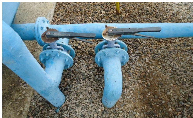
Figura 08 - Válvulas para limpeza dos filtros.
