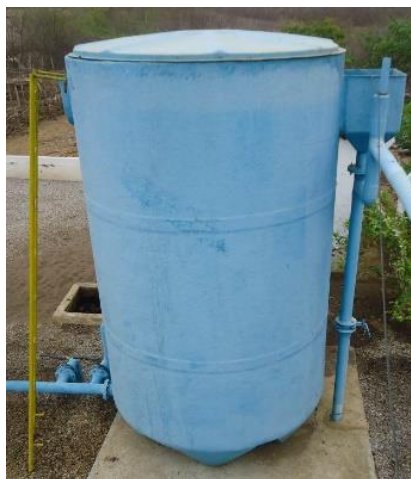
Figura 06 - Filtro da ETA.
