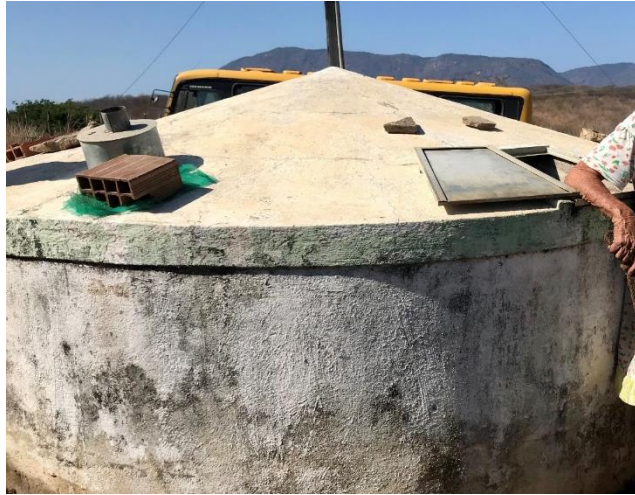
Figura – Cisterna de Placa na Localidade de Rio do Canto
