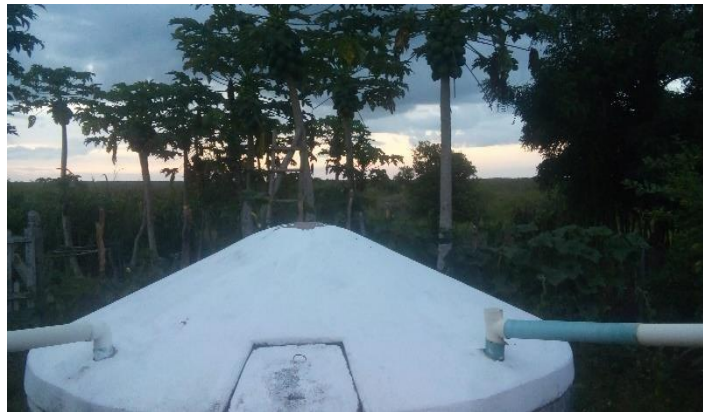
Figura 01: Cisterna de placa
