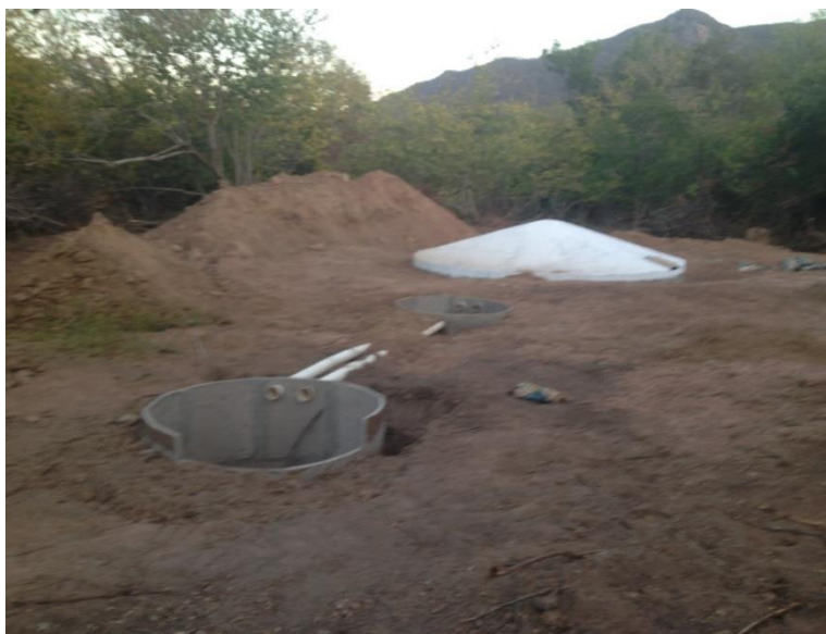
Figura 6 – Dois tanques de decantação e cisterna de placas, em sequência.
